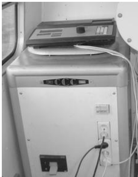
Рис. 7. Внешний вид блока высоковольтного выпрямителя
